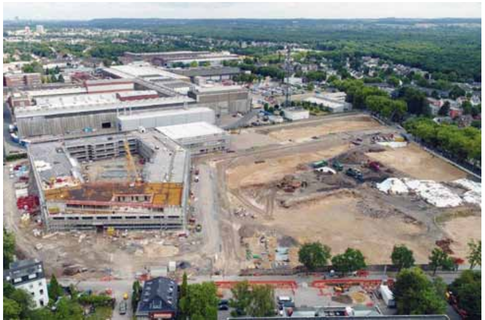
Die Rohbauarbeiten des Albrecht-Dürer Kollegs sind fertig, die Bodensanierung der Wohnflächen wird in Kürze abgeschlossen. Links eine Visualisierung der Schule vom großzügigen Vorplatz
